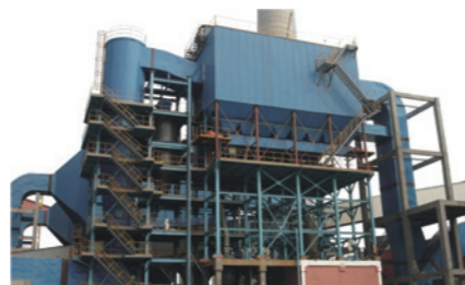
▲ 热电厂垃圾焚烧除尘 Waste Incineration
